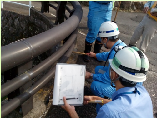
ハンマーでたたきながら橋の上面を点検
