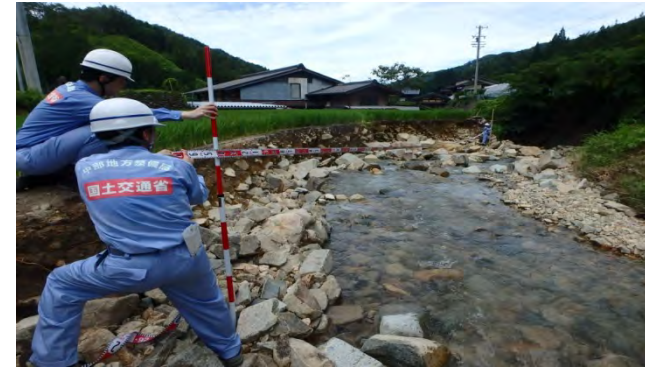
河川の被災状況現地調査 (岐阜県下呂市)
