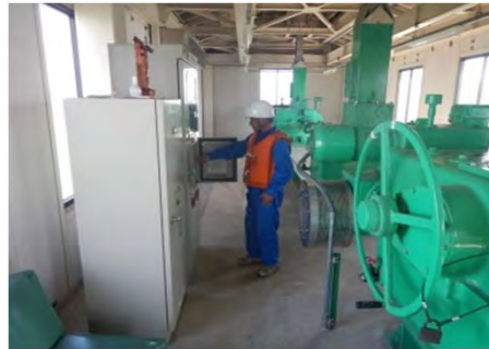
岐阜県 排水樋門の操作
