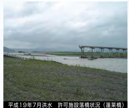
平成19年7月洪水 許可施設落橋状況（蓬萊橋）
