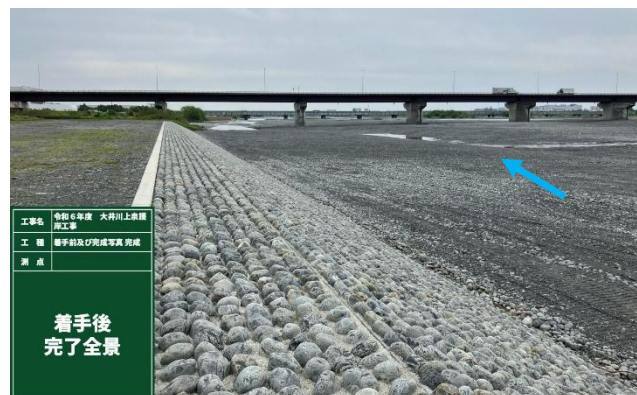
令和6年度 大井川上泉護岸工事 低水護岸整備(上泉地区)大井川 5.8k付近 左岸
