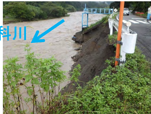
被災状況(上流側)
