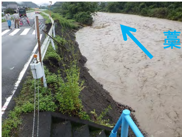
被災状況(下流側)
