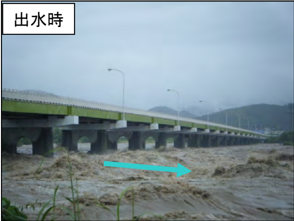
平成23年9月台風12号出水 谷口橋(10km付近右岸下流)
