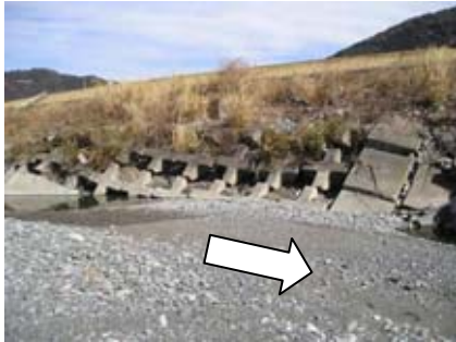
河床低下による護岸の破損
