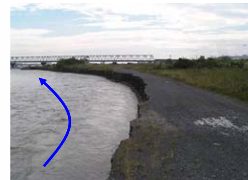
8.4k付近の河岸侵食状況(H16.10撮影)
