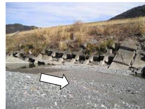
22km付近の河床洗掘状況
