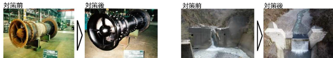
老朽化したポンプ設備の修繕・更新により、災害のリスクを軽減
