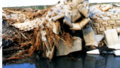
洪水時の低水護岸 被災状況
