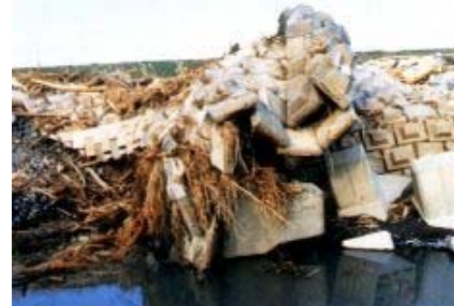
護岸被災状況
