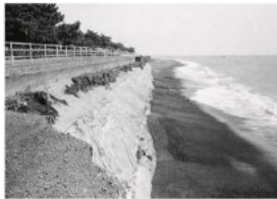
清水海岸の被災状況
