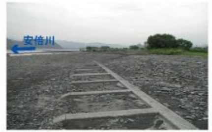
土砂の堆積により河床の高さが上昇しています。(安倍川左岸6.0k付近)
