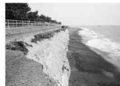
清水海岸の被災状況
