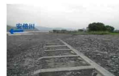
土砂の堆積により河床の高さが上昇 しています。(安倍川左岸6.0km付近)
