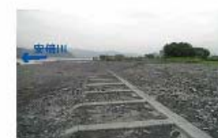
土砂の堆積により月床の幅さが上昇 しています。(安倍川 土井5.0k付近)
