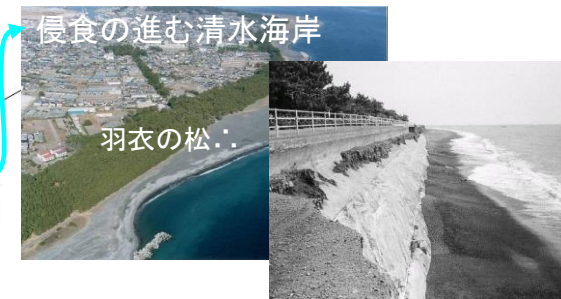
清水海岸の被災状況(H4)
