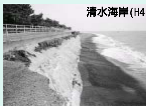
清水海岸の被災状況
