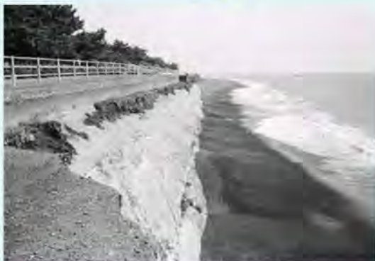
清水海岸の被災状況 (平成4年)
