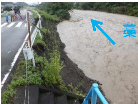
被災状況(下流側)
