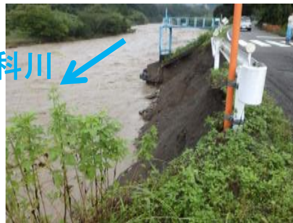
被災状況(上流側)
