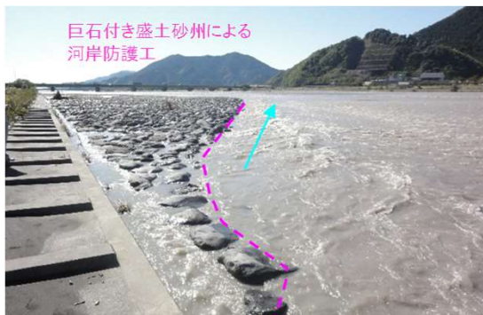
図 出水時の巨石付き盛土砂州周辺の状況
