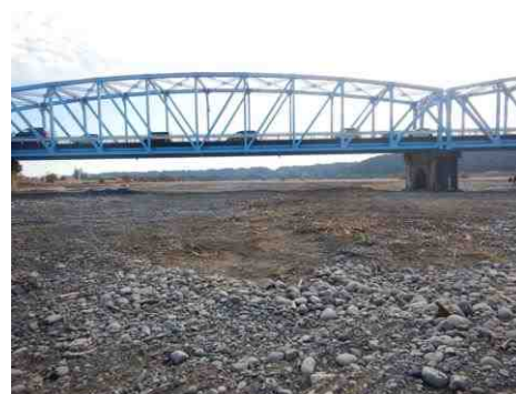
図－11 左記処理後の状況
