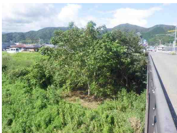
図-11 河川管理に支障となる雑木
