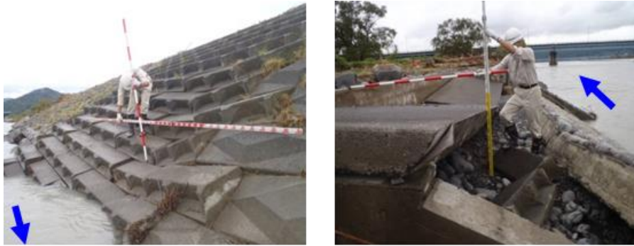
図 3-20 河床低下による護岸等の崩壊（平成 23 年度被災；17.2km 付近左岸）
