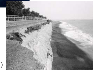
清水海岸の被災状況(H4)
