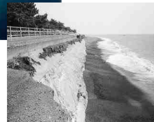
清水海岸の被災状況(H4)
