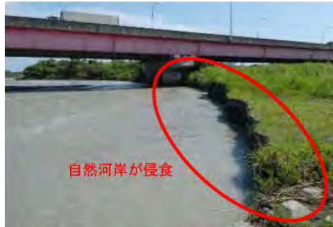
令和2年7月豪雨での被災状況(右岸1.5k)
