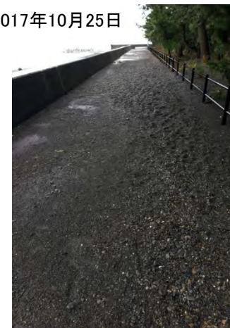
堤防背後の管理用通路へ運ばれた大量の砂礫
