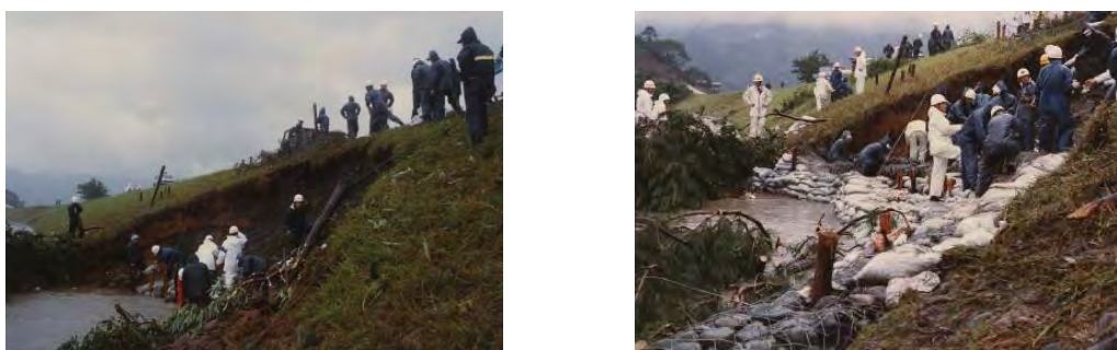
図 5-9 昭和 57 年 8 月洪水における堤防の被災状況
