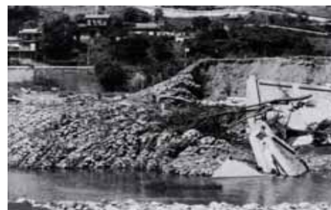
松野 コンクリート法面の被災状況(昭和49年、台風8号)
