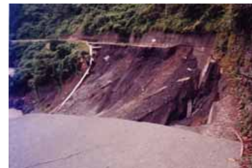
県道横刈附近の欠損状況
