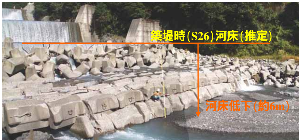
砂防えん堤下流の河床低下
