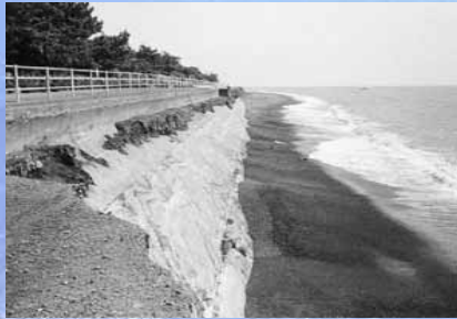
清水海岸の被災状況
