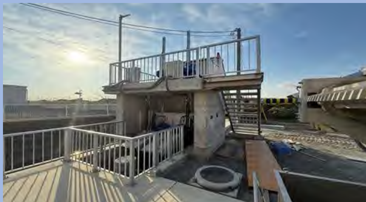
【R7年度】排水ポンプ場の整備 【普通河川から二級河川坂口谷川への流出部】
