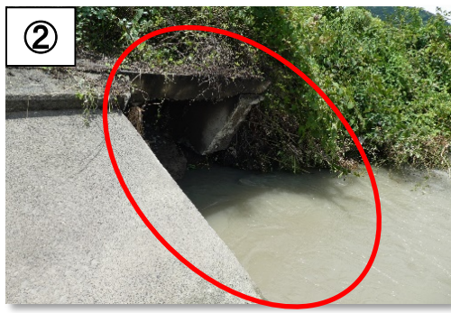
静岡市牧ヶ谷地先(藁科川右岸0.5k) 7/28 11:30頃現地調査
