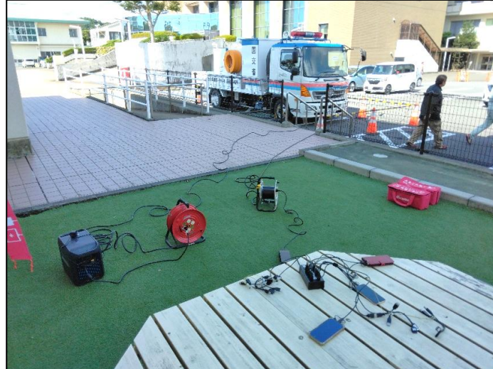
排水ポンプ車による電源支援(牧之原市内)
