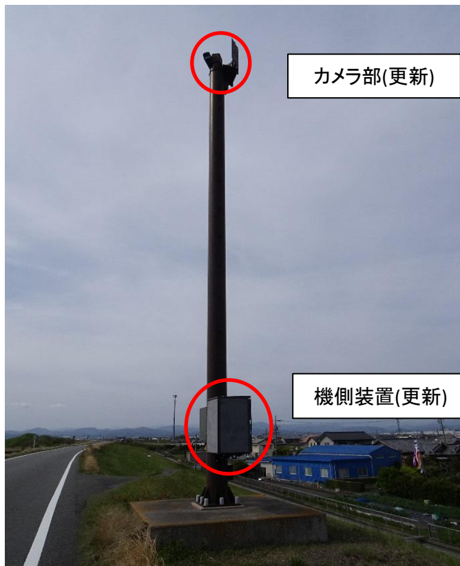
代表箇所：太平橋左岸CCTV
