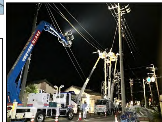
照明車を牧之原市での中部電力の夜間復旧作業にも使用しました。
