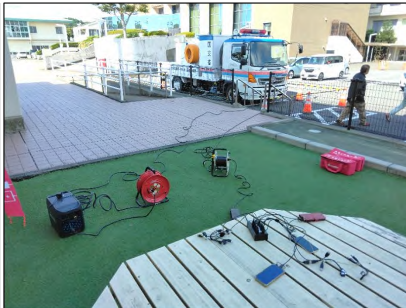
排水ポンプ車による電源支援(牧之原市内)
