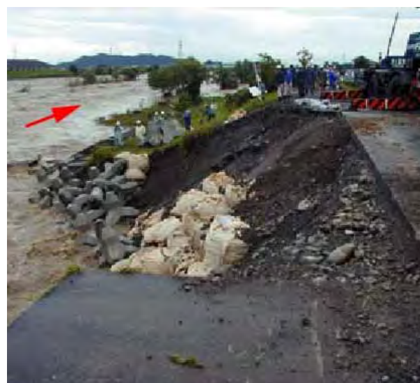
堤防の一部損傷
