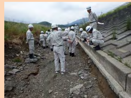
欠壊箇所の確認
