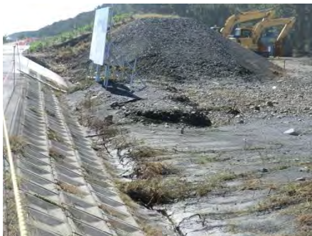
堤防裏法に流出痕 焼津工区
