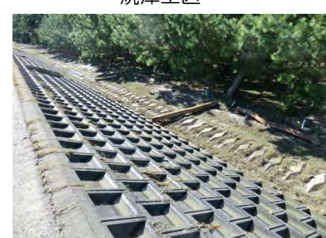
堤防裏法尻に流木散乱 大井川工区
