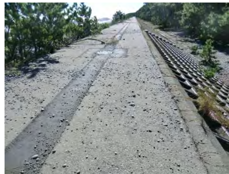
堤防天端に石・流木散乱 大井川工区
