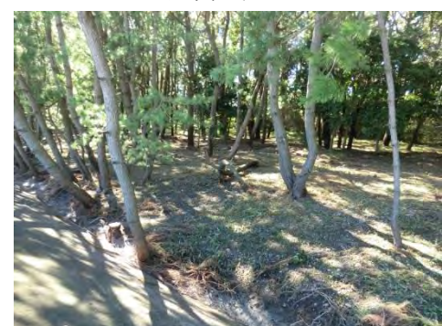
堤防裏法 立木に洗掘痕 焼津工区
