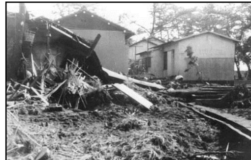
昭和41年9月台風26号 高波・浸水により被災した家屋 (焼津工区田尻地先)
