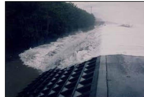
平成9年9月台風20号 越波による浸水 (焼津工区一色地先)
