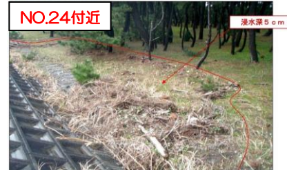
【平成25年10月台風26号による越波】
