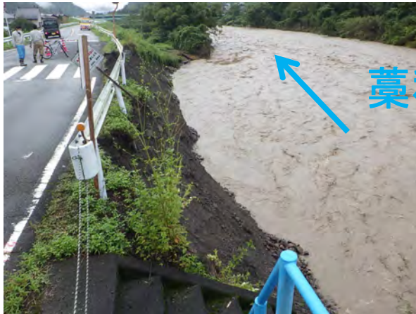
被災状況(下流側)
