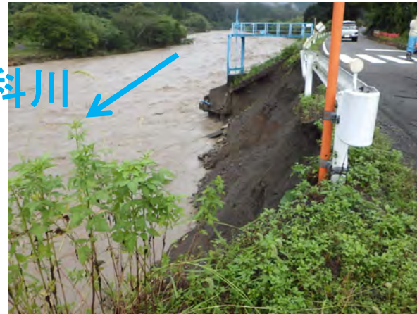
被災状況(上流側)
