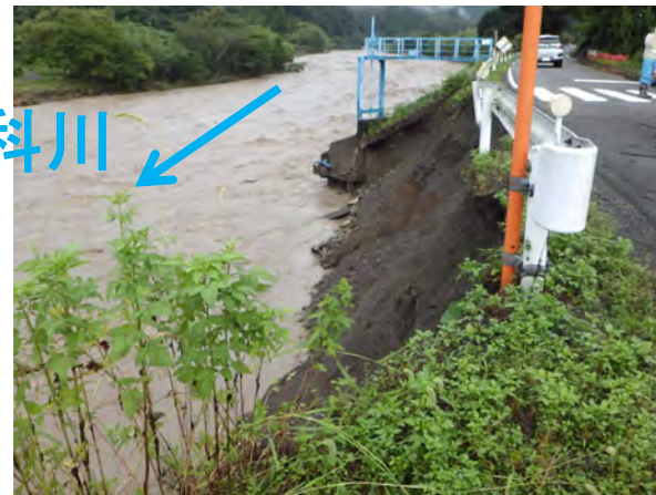
被災状況(上流側)
