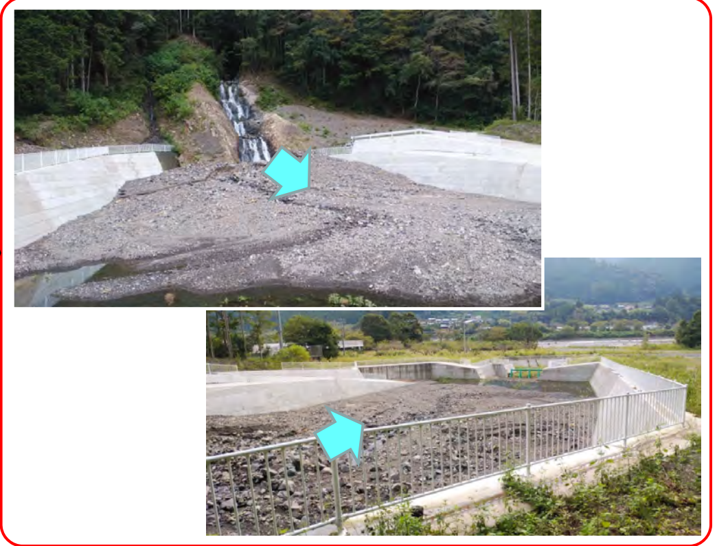
土石流発生後 (R4.9.28撮影)
