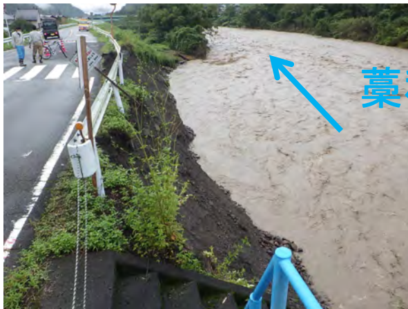
被災状況(下流側)
