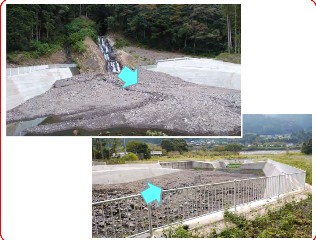
土石流発生後 (R4.9.28撮影)
