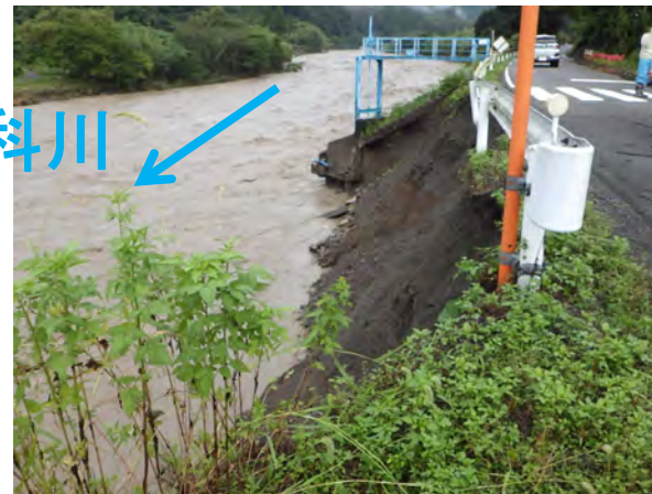
被災状況(上流側)
