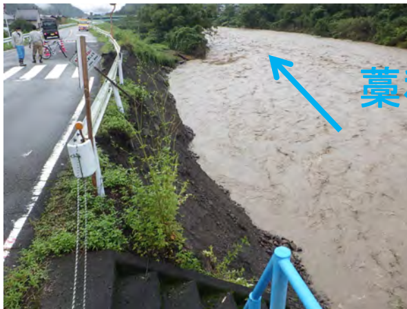
被災状況(下流側)
