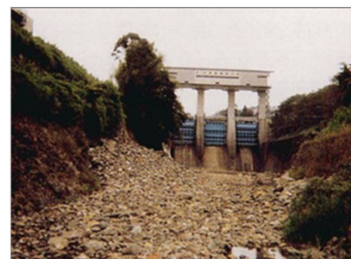
川底が露出する大野頭首工下流の様子
