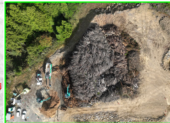
④添沢地区整備(添沢地区)
