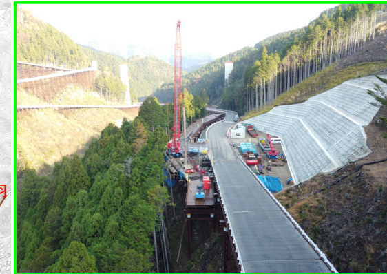
③田口地区貯水池斜面対策
