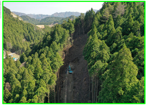
⑤大名倉地区斜面对策(近景)
