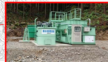
呑口部 濁水処理設備
