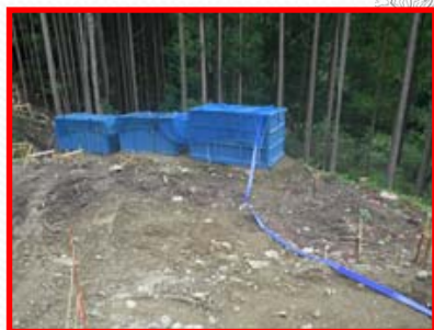
ノッチタンク(仮設沈砂池)
