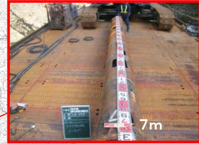
従来はケーシング12mであるが、騒音・振動が小さい7mのダウンザホールハンマーを採用(騒音・振動の発生の少ない工法の採用)
