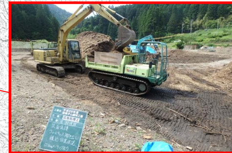
【滝瀬遺跡】未利用材をチップ化し裸地からの濁水の発生の軽減を実施
