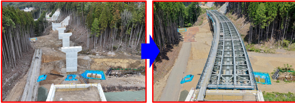
①令和4年度 設楽ダム設楽根羽線3号橋鋼上部工事 (令和6年5月完成)
