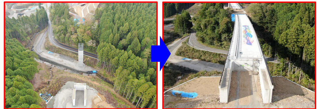
⑤令和4年度 設楽ダム国道257号1号橋PC上部工事 (令和6年10月完成)
