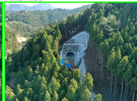
③大名倉地区斜面对策(近景)
