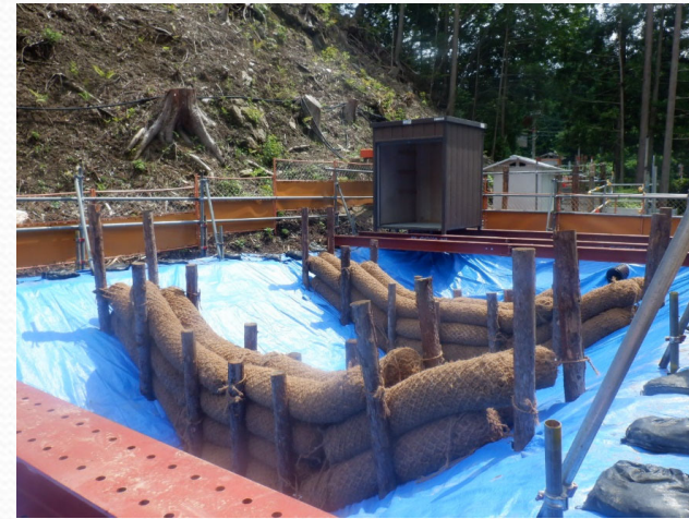
環境配慮型フィルターの採用
