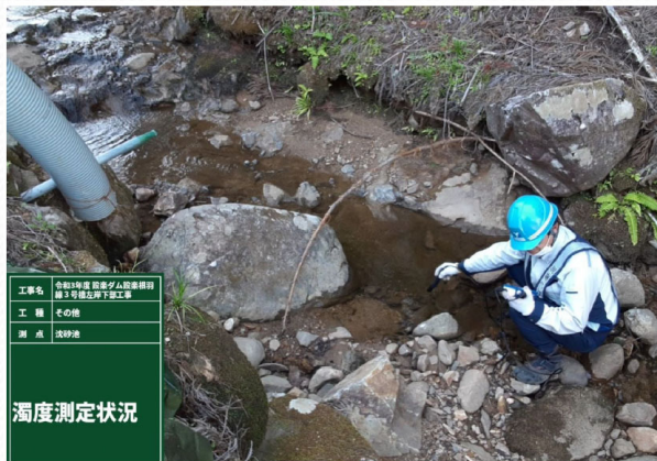
沈砂池における濁度測定状況
