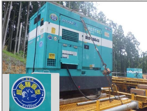
超低騒音型発電機の採用
