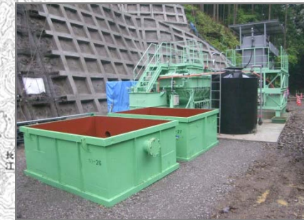
濁水処理設備 転流工呑口部
