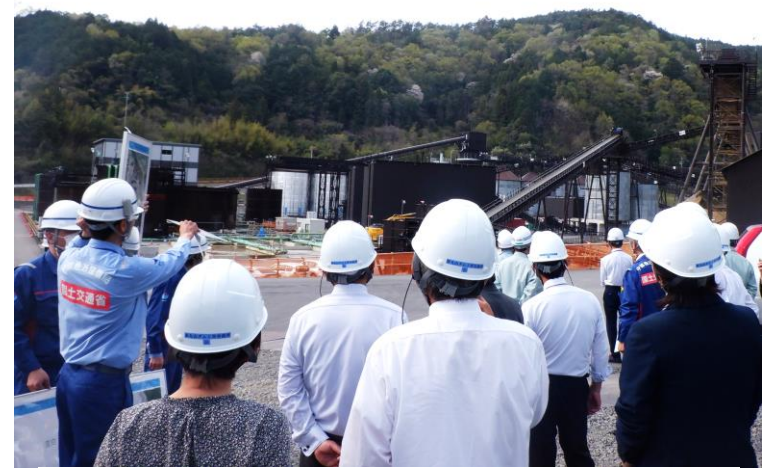
ダム用コンクリート骨材の製造設備
