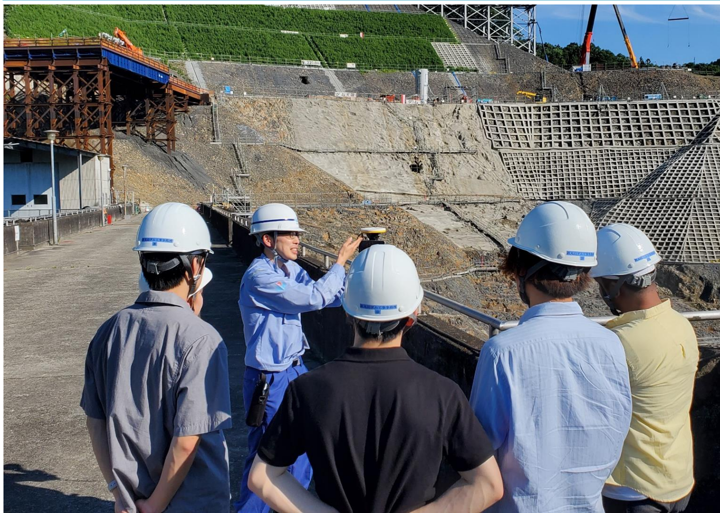
AR (拡張現実) を体験しつつ丸山ダムから新丸山ダム工事現場を見学
